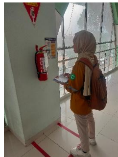
Gambar 1.17 Sistem Proteksi Kebakaran APAR
