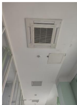
Gambar 1. 29 Smoke Detector dan Sprinkle
